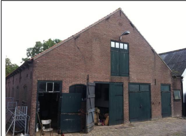
Foto 3. Schuur met tochtgaten in enkelsteense gevel
