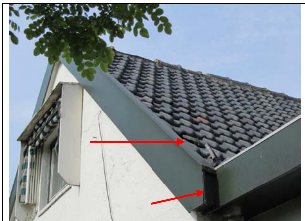
Foto 7: Losliggende dakpan en opening waar vleermuizen onder kunnen wegkruipen.
