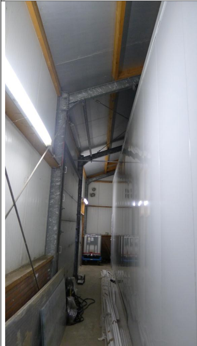
Binnenzijde WKK gebouw, rechts omkasting WKK
