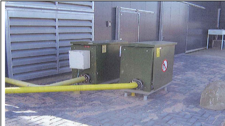
Gasstations met gasleidingen
