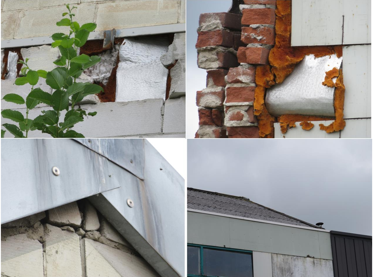
Links: Opgevulde en niet opgevulde gaten in cellenbeton. Rechtsboven: Door het ontbreken van de zijmuur en meerdere gaten in de muur, ontstaat tocht in de spouw. Rechtsonder: Sluitend dak.
