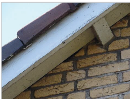
Foto 26: Openingen bij dakrand (oostzijde woning).
