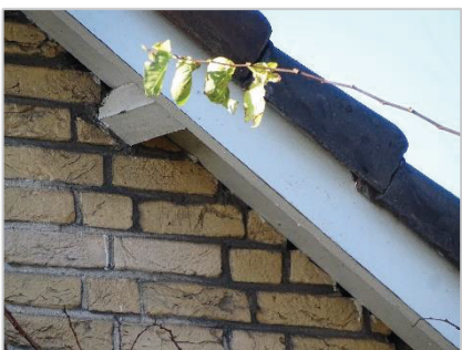
Foto 23: Openingen bij dakrand (oostzijde woning).
