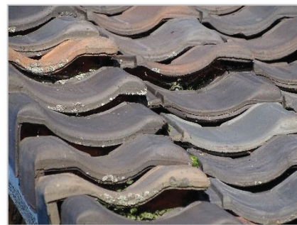
Foto 22: Losse dakpannen (westzijde woning).
