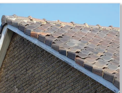
Foto 21: Losse dakpannen (westzijde woning).
