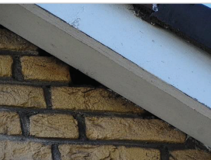
Foto 24: Openingen bij dakrand (oostzijde woning).
