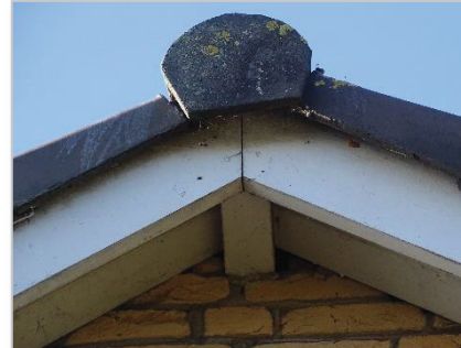
Foto 25: Openingen bij dakrand (oostzijde woning).
