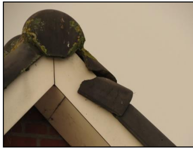
Figuur 10. Foto van gebroken dakpannen, mogelijke ingang voor huismus en vleermuizen
