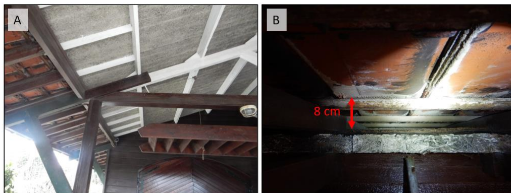
Figuur 4 Visuele indruk van het dak van de schuur. (A) de houten beplating onder het dak begint niet aan de dakrand, maar enkele dakpannen hoger, (B) de ruimte tussen de dakpannen en houten beplating is groot (circa 8 cm) en houten latten tegen de beplating ontbreken. Hierdoor worden nesten niet tegengehouden, waardoor deze van de beplating af kunnen schuiven.
