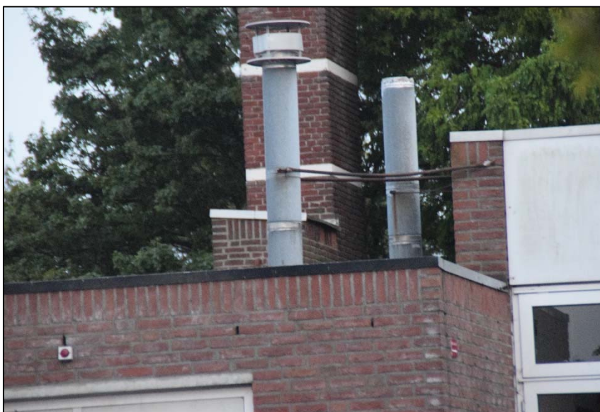
Spouwgaten in een muur van het lage deel van het gebouw. Deze gaten geven mogelijk toegang tot voor vleermuizen geschikte holtes.
