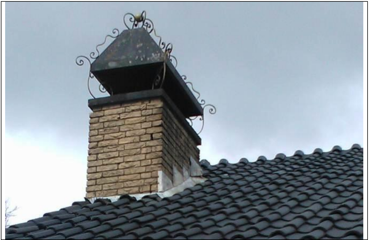
Foto 1. Pannendak met losliggende pannen en spouwgat in de schoorsteen van de woning aan de Emmastraat 4
