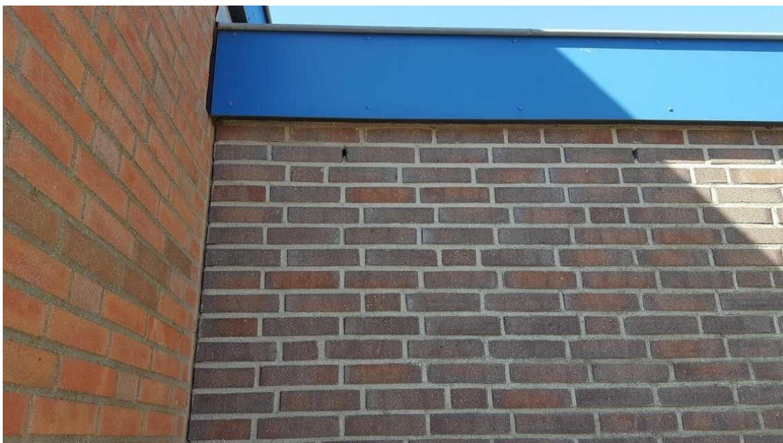
Figuur 6: Open stootvoegen in de gevel.
