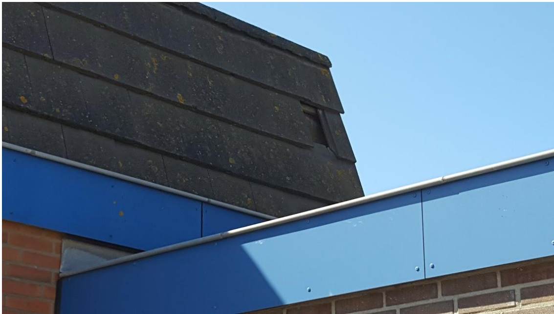
Figuur 7: Ontbrekende dakpan.
