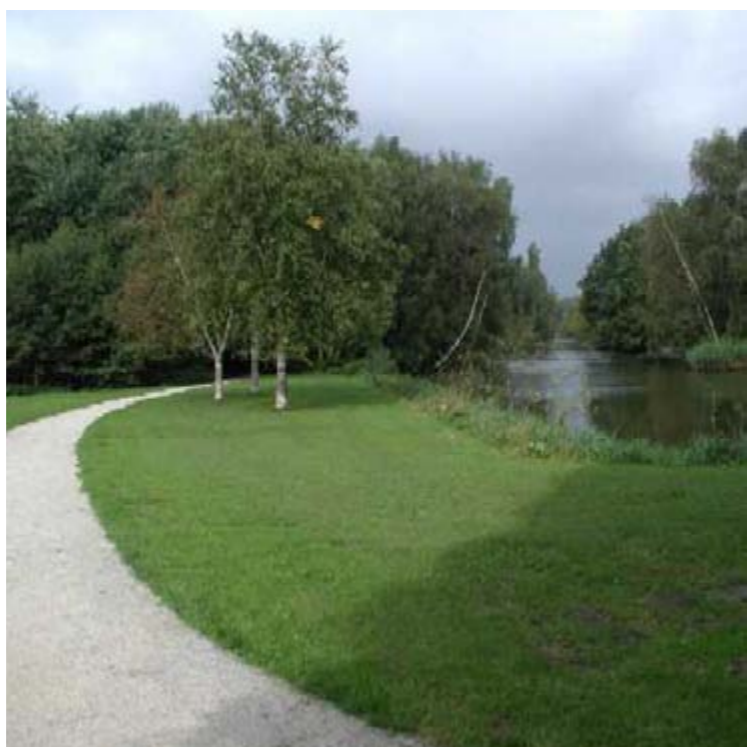
Karrenspoor in asfalt met slijtlaag
