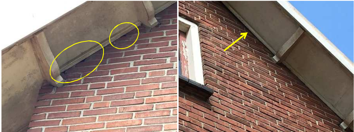
Potentiële invliegopeningen in het gebouw. Deze openingen bieden vleermuizen de kans een verblijfplaats te bezetten in de spouw.
