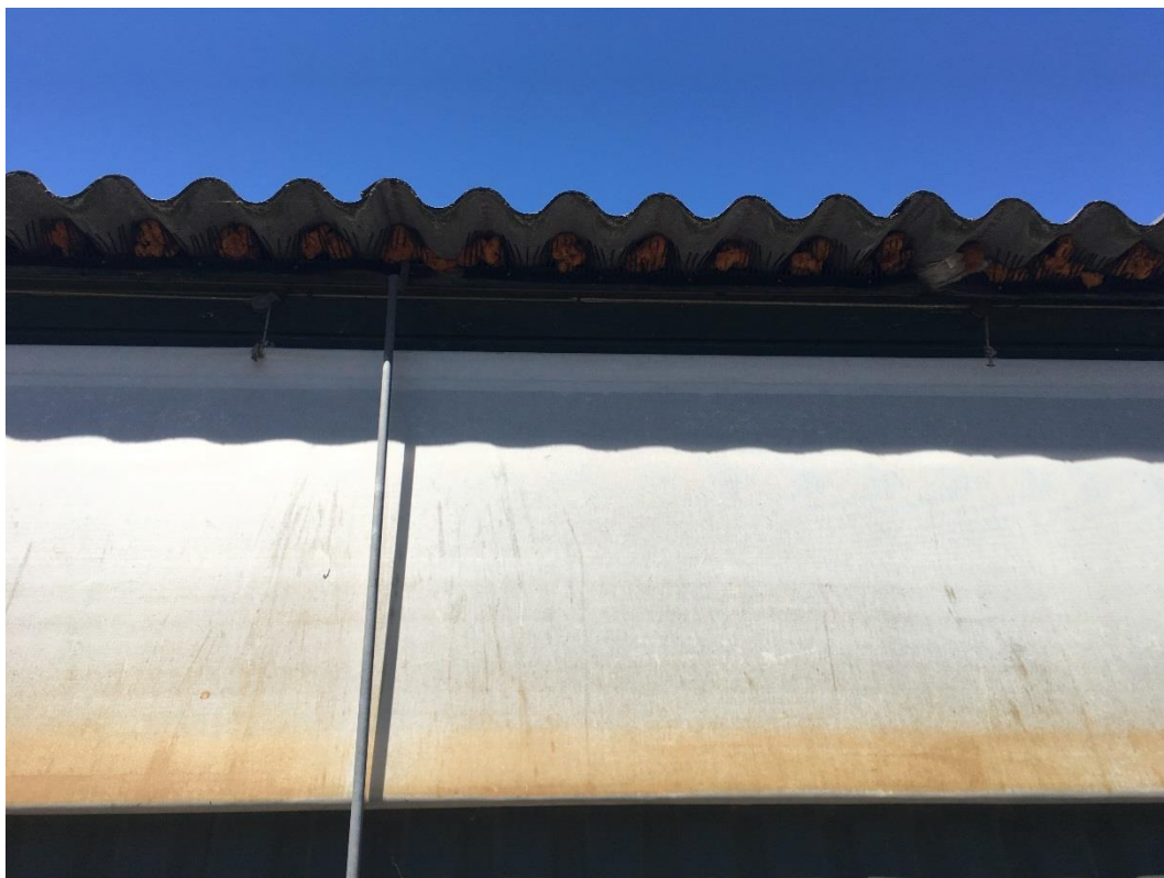
Figuur 5. Impressie plangebied, situatie op 2 juli 2018. Golfplaten dak met vogelschroot en pur.
