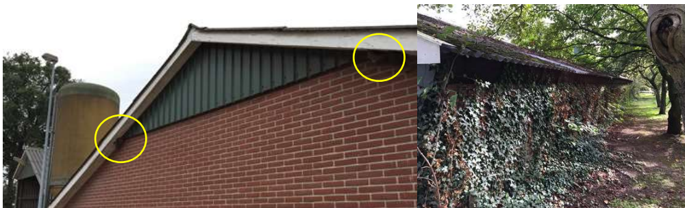
Links: huiszwaluwnesten aan de gevel van een te slopen stal in deelgebied Haarstraat. Rechts: klimop aan de gevel van de stal in deelgebied Wiekerstraat. Deze klimop vormt een potentiële nestplaats van verschillende vogelsoorten.
