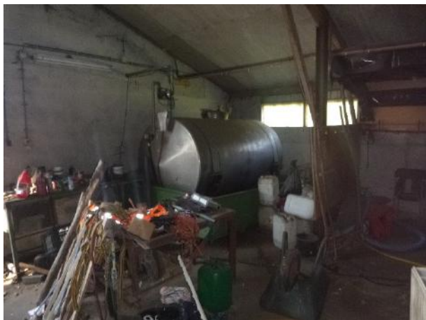
Bovengrondse dieseltank (inhoud 4200 liter)
