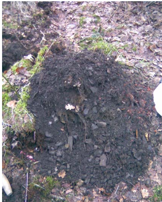
Vrijkomende grond met stukjes asbest uit een proefsleuf
