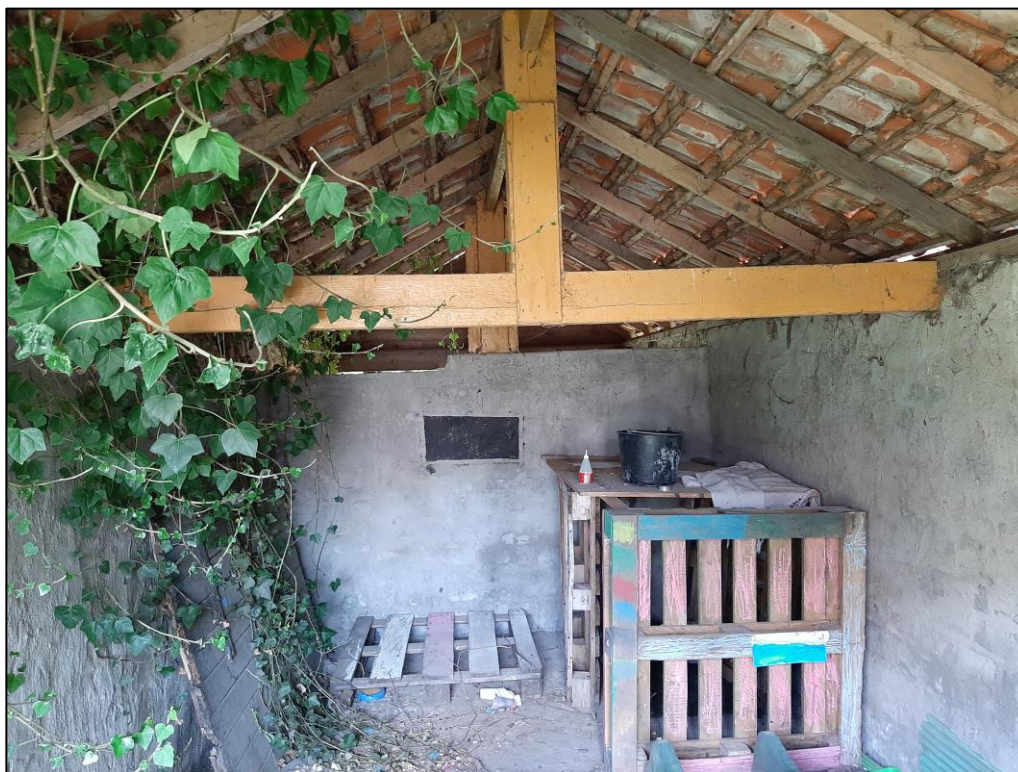
Figuur 2 De binnenzijde van de kleine schuur, het dak heeft geen dakbeschot.
