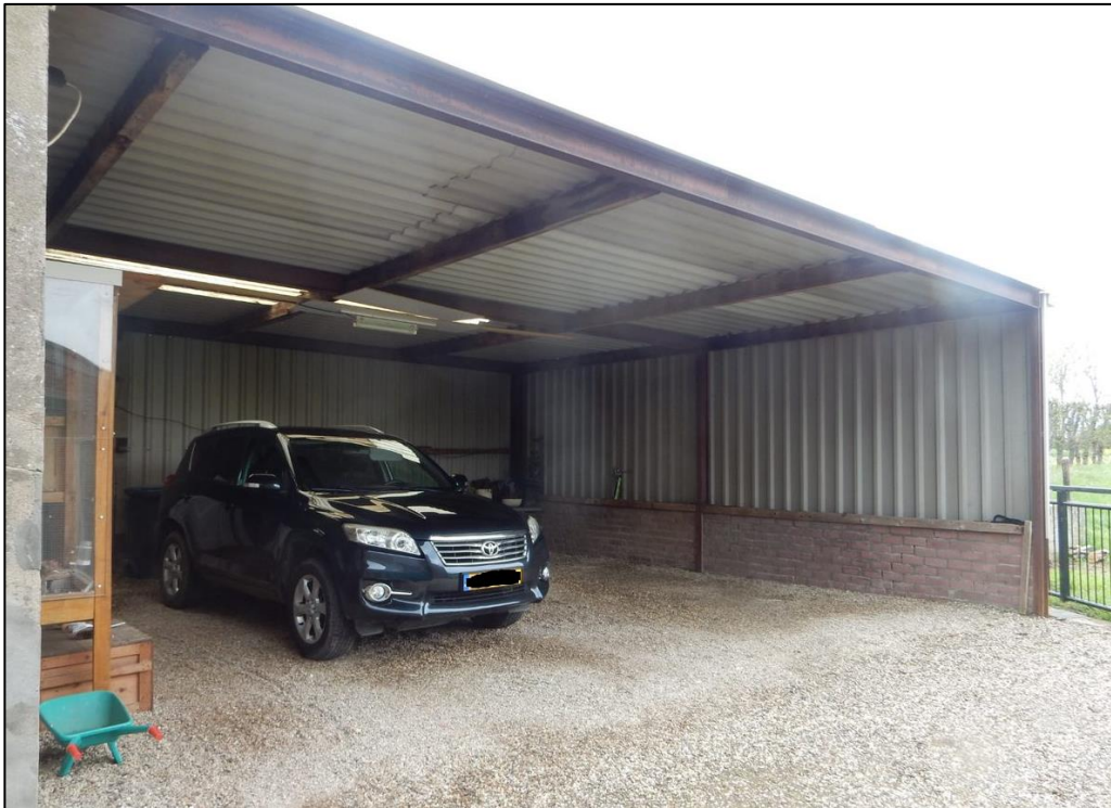
Figuur 5 De overkapping. Deze zal gesaneerd worden.
