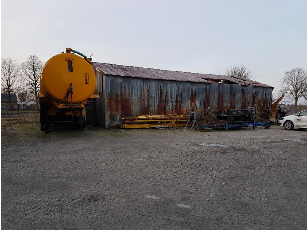
Figuur 3 Vervallen schuur aan de westzijde van het plangebied.
