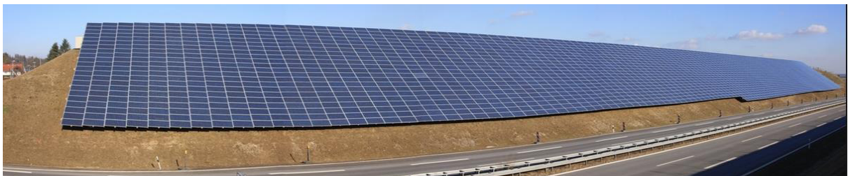
Afbeelding 19: Zonne installatie langs de A94 dicht bij Toting
