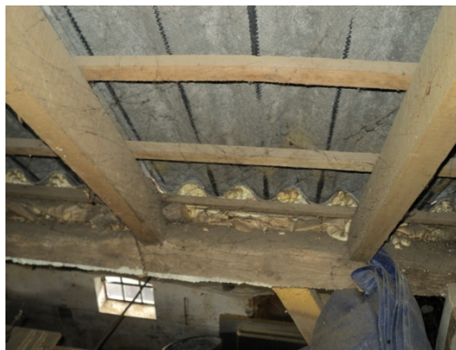
De isolatie stopt bij de zoldering. Hier bestaat het dak uitsluitend uit kale golfplaten.
