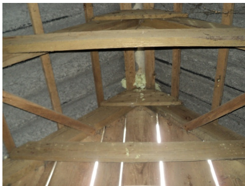
De kopgevel ten noorden bestaat ter hoogte van de zolder uit houten planken waardoor veel tocht ontstaat.
