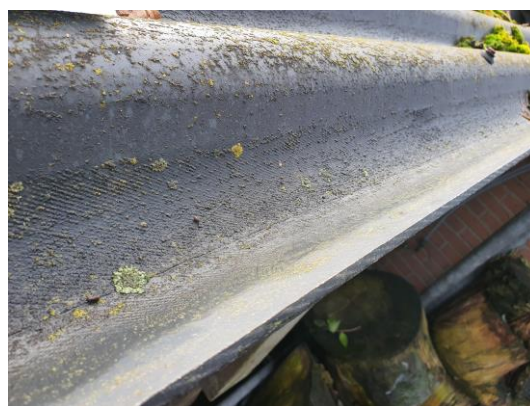
afdak golfplaten asbestvrij (NT markering)
