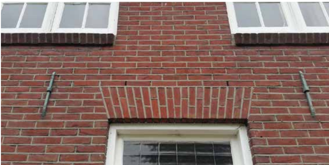
Open stootvoegen in de te slopen woning.
