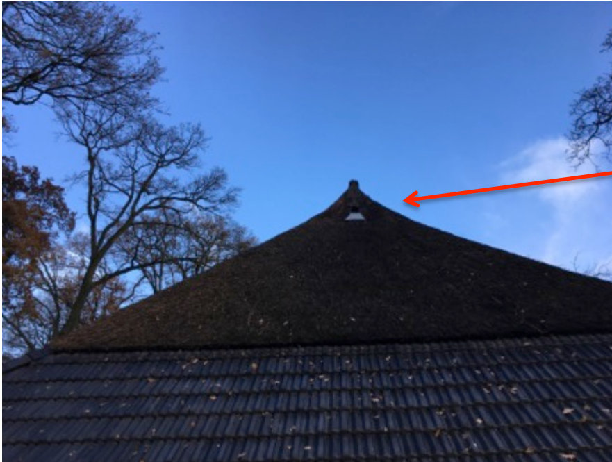
Foto van nok van schuur (zuidzijde) waarin een uilenkast is geplaatst.
