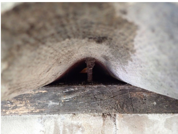
Foto 5: de schone holte onder cementgebonden plaat. Alle holten waren schoon.
