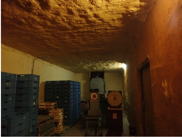
Foto 12: een met pur schuim geïsoleerde koelcel.
