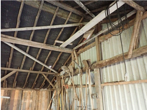
Foto 6: wand en dak van de werktuigenberging. Op een van de horizontale balken is een oud merelnest aangetroffen.
