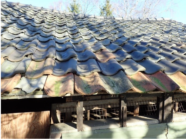
Foto 3: de kierende pannen en de lage dakrand aan de zuidzijde.
