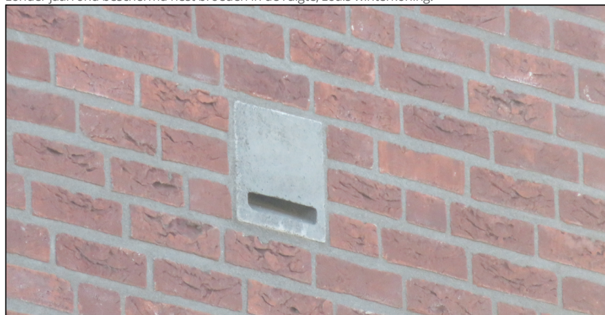
Figuur: een inbouwvleermuiskast is aanwezig in een woning ten westen van het plangebied. Hier kunnen vleermuizen invliegen en verblijfplaatsen hebben. Deze verblijfplaatsen kunnen verstoord worden als er verlichting wordt geplaatst.
