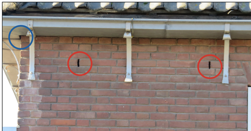
Figuur: de muren van de winkel (nr 33) hebben open stootvoegen (rode cirkels) waar vleermuizen kunnen invliegen en verblijfplaatsen kunnen hebben in de spouwmuur. De opening bij de dakgoot (blauwe cirkel) is te klein (<2cm breed) voor gierzwaluw.
