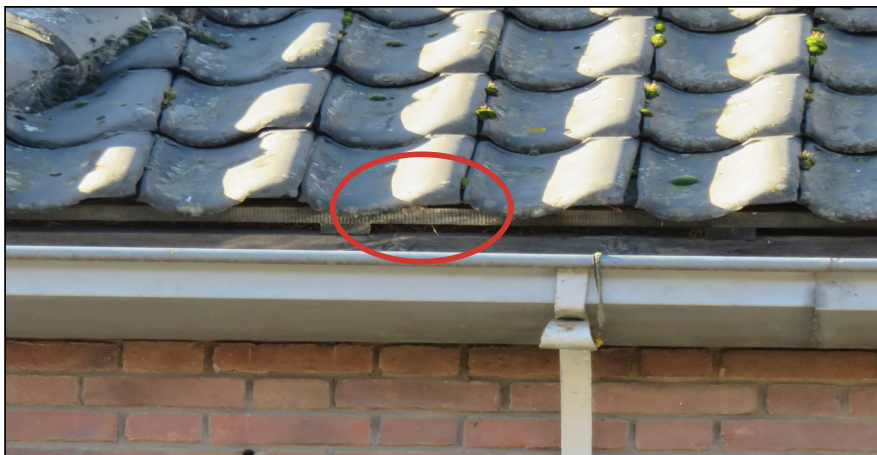
Figuur: onder een dakpan van de winkel (nr 33) is nest materiaal aangetroffen (rode cirkel). Dit betreft vermoedelijk een nest van huismus. Hoewel er houten latten onder de onderste rij dakpannen aanwezig zijn, is er voldoende ruimte voor de huismus om te broeden.
