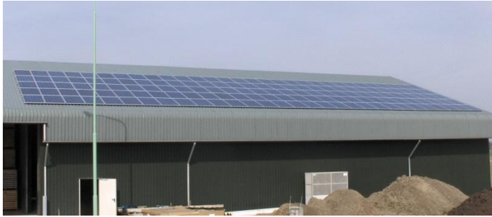
Zonnepanelen op een loods, die makkelijk inpasbaar zijn
