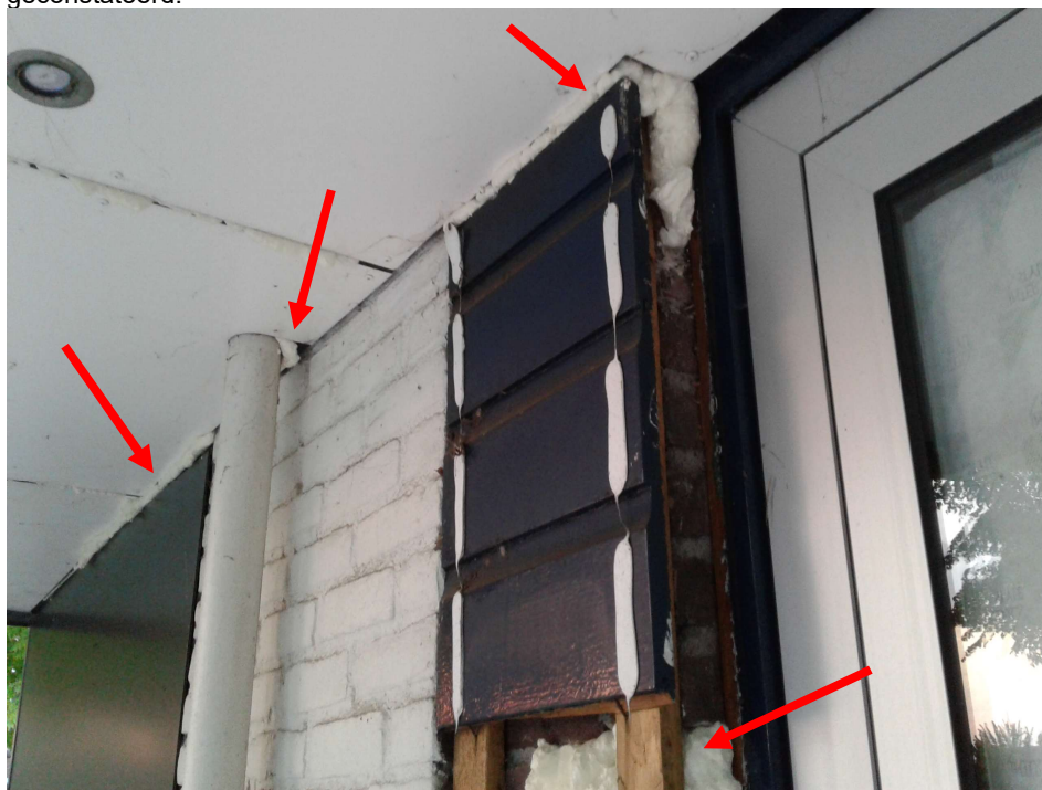
Foto 1 Voorbeelden van voor aanvang van het nader onderzoek dichtgemaakte openingen
