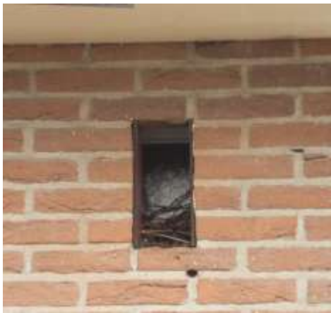
Oud nest van holenduif in een te slopen gebouw in het plangebied.
