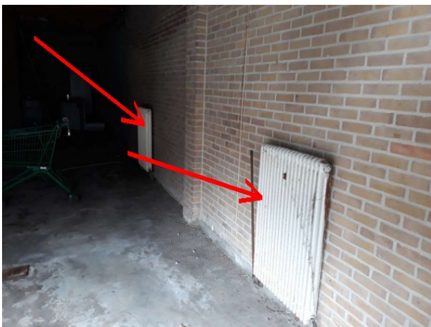
Foto 5: 2 ledenradiatoren in de garage
