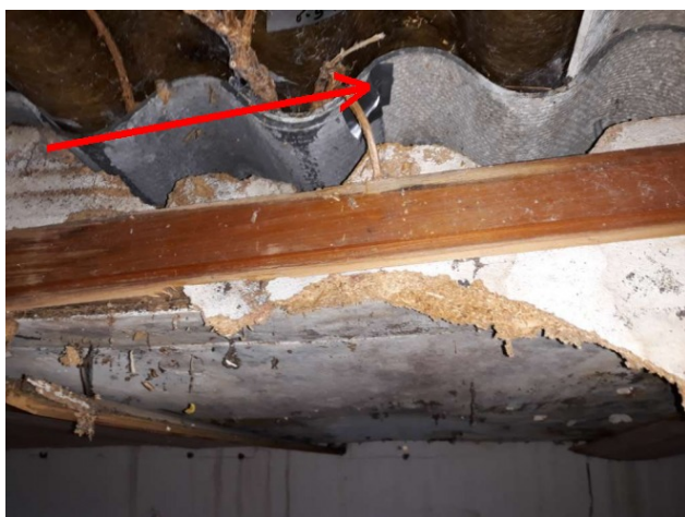
Foto 1: MM12, golfplaten dak schuur
