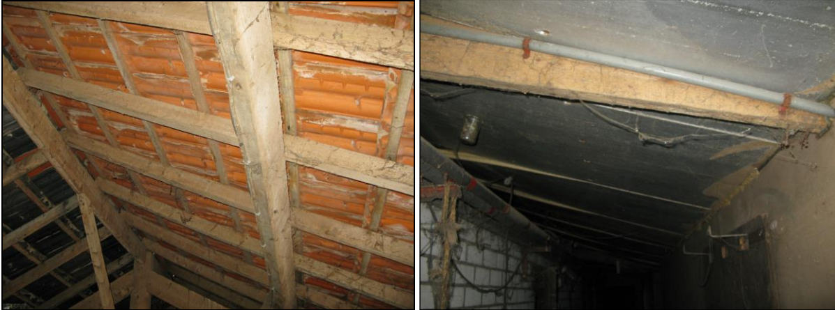
Figuur 17: Dak(beschot) te saneren stallen
