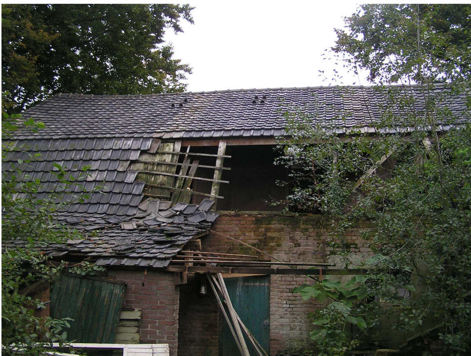
Figuur 4: Deels ingestorte bovenverdieping van het woonhuis.
