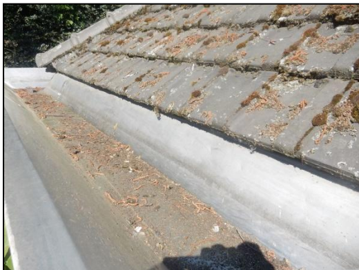
Figuur 10. Afwezigheid van voldoende ruimte voor huismus tussen dakpannen en dakrand.
