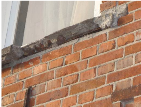
Foto links: betonnen dorpels dienen voor een deel hersteld te worden
