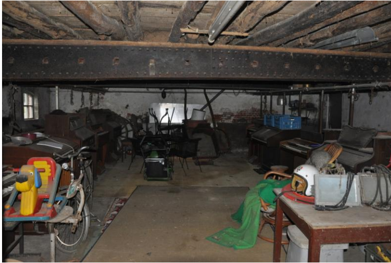
Afb. 22. Centrale as in koeienstal, met molenroede als overspanningbalk voor de zoldervloer.
