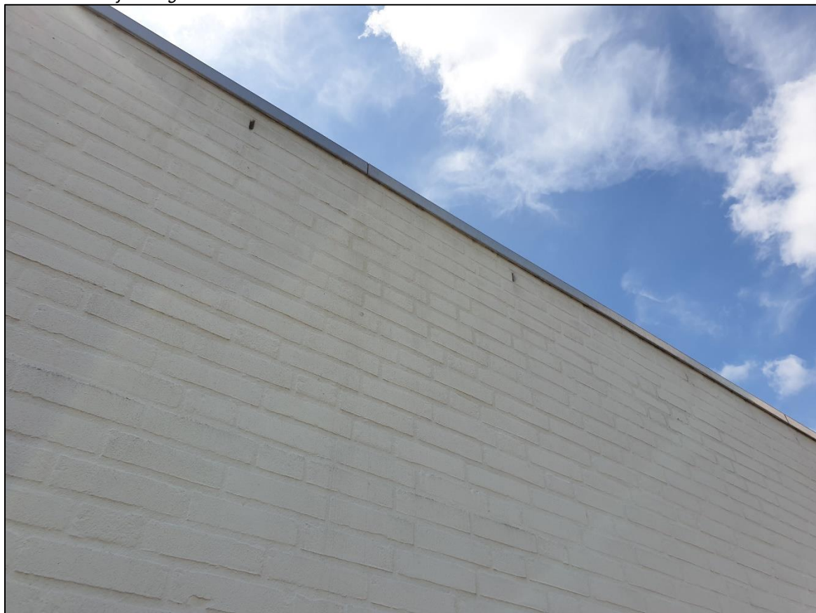
Foto 2. Smalle open stootvoegen zorgcentrum
