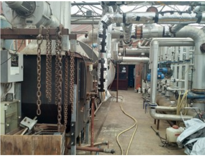
Afbeelding binnenkant ketelhuis
