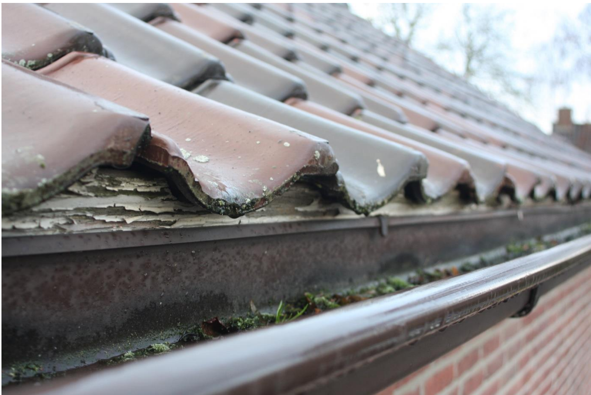
De onderste laag dakpannen is afgedicht en niet toegankelijk voor vogels en/of vleermuizen
