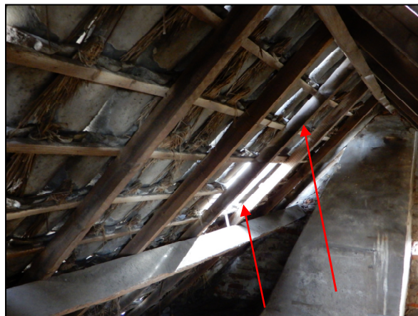
Foto 5: ruimtes tussen dakpannen bieden toegang tot de zolder
