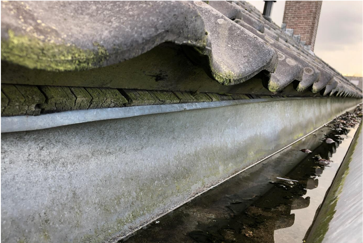
Onder de onderste laag dakpannen bij de woning aan 't Dorp 116/118 is een lat bevestigd.
