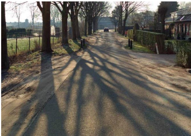
Figuur 9, onverharde berm met schade en paaltjes Koffiestraat
