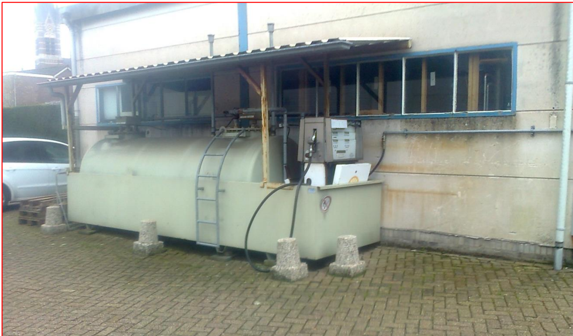
Foto 2. Bovengrondse tank met lekbak.
