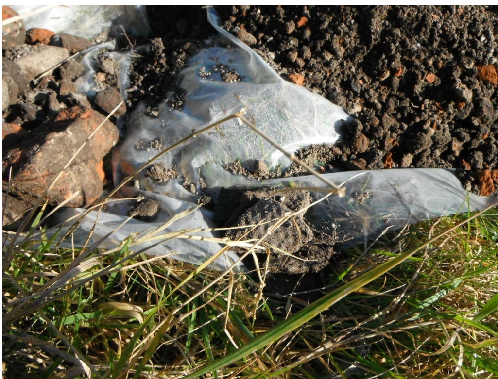
Foto 6. Asbestinspectiegat B10 asbestverdacht materiaal ASB-2 (golfplaat dik)
