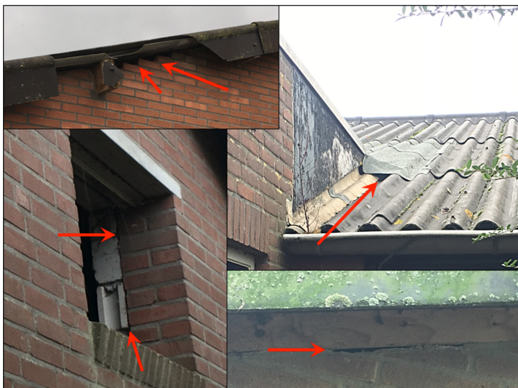
Figuur 2 De rode pijlen geven de openingen aan welke kunnen dienen als tijdelijke rustplaats van vleermuizen.
