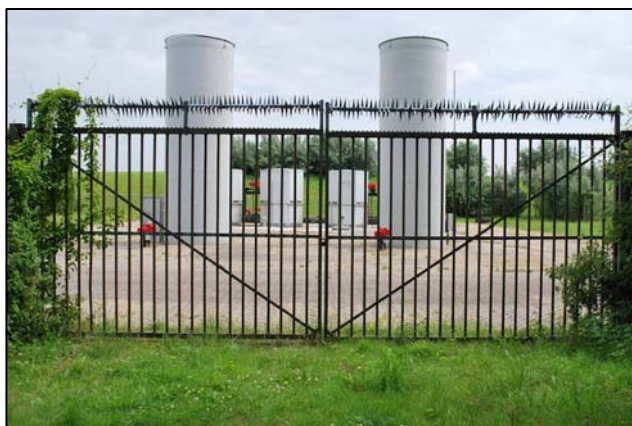
Pompstation ten westen van spaarbekken De Gijster
