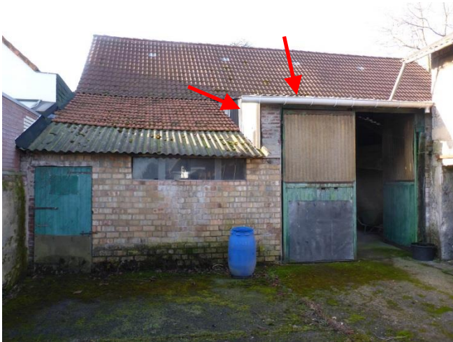
Foto 3 schuur: golfplaten op dak en tegen gevel
