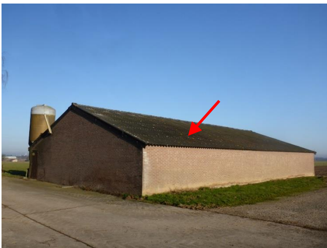
Foto 11 varkensstal: golfplaten op dak
