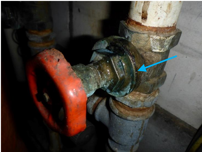
Foto 18 niet-asbesthoudende pakking leidingen cv-ruimte
