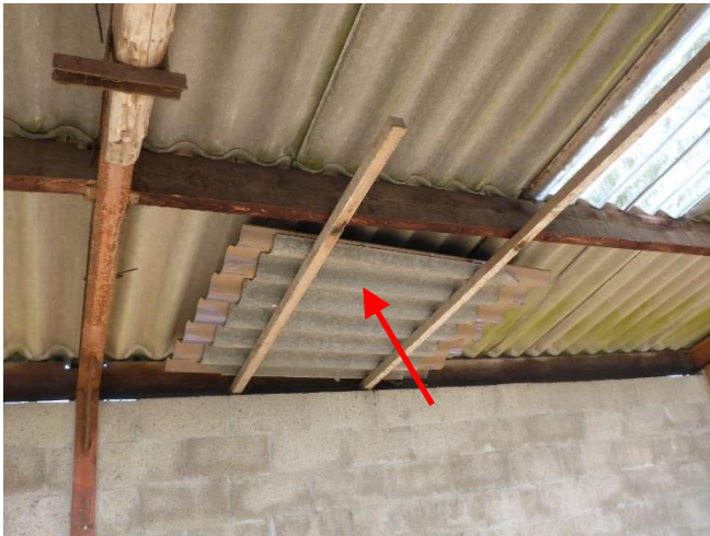
Foto 9 veldschuur 2: losse golfplaten aan onderkant dak
