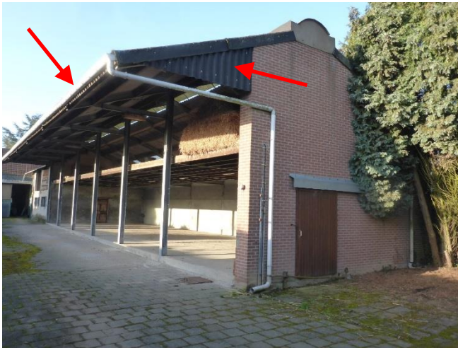
Foto 7 veldschuur 1: golfplaten op dak en tegen gevel
