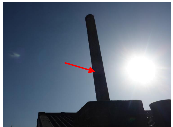
Foto 12 varkensstal: rookgaskanaal vanaf cv-ketel
