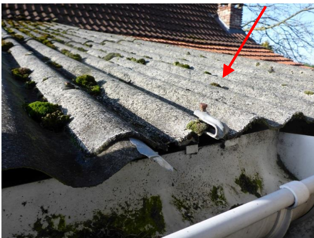
Foto 5 schuur: golfplaten op het dak
