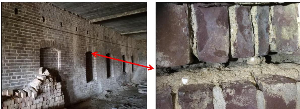
Figuur 10 en 11. Scheuren en nissen in de binnenmuren van het gebouw.
