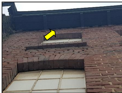
Figuur 14. Ruimte tussen muur en overstek.
