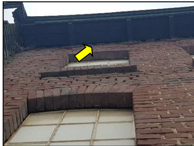
Figuur 10. Ruimte tussen muur en overstek.
