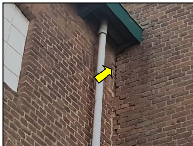
Figuur 13. Scheur in hoek van muur.
