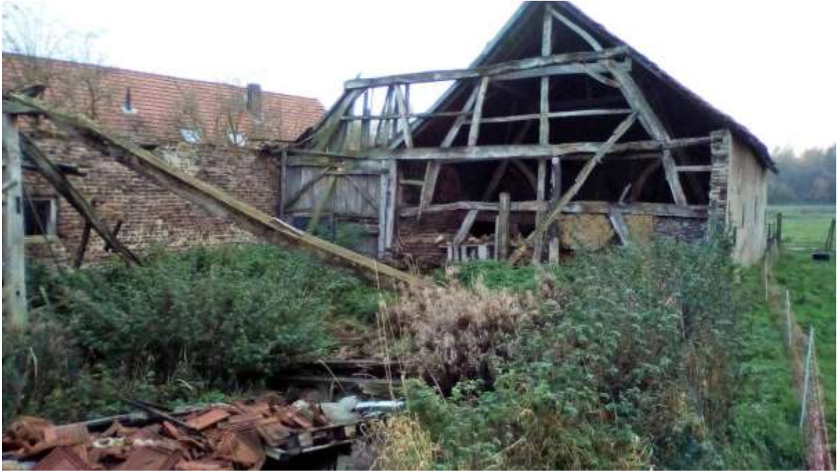
Figuur 7: Het ingestorte noordelijke deel van de historische boerderij Gebroekerdijk 37
