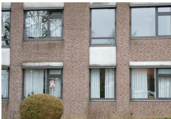
Fig. 7 Beide gebouwen hebben op diverse plaatsen open stootvoegen.
